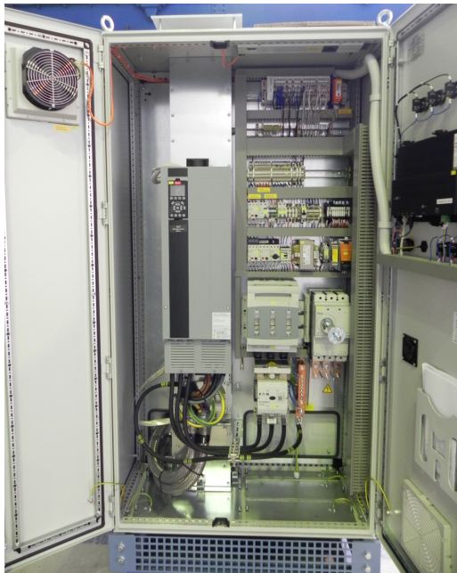
Abb.8: GEA Omni Schaltschrank Innenansicht (Frequenzumformer im Schaltschrank eingebaut)
